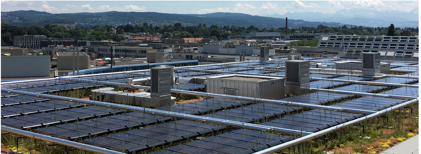
1'143m 2 Solarpanels generieren 600 kW Leistung
